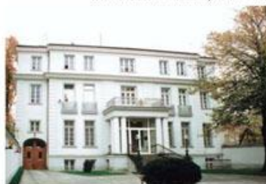
Budynek Ambasady Watykanu w Warszawie osuszony w 2001 r.
