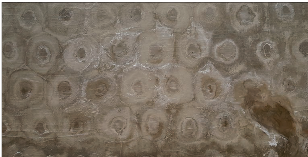
Fot. 2. Przykład realizacji geometrii otworów iniekcyjnych dla izolacji pionowej przeciwwilgociowej w technologii Iniekcji Krystalicznej®
